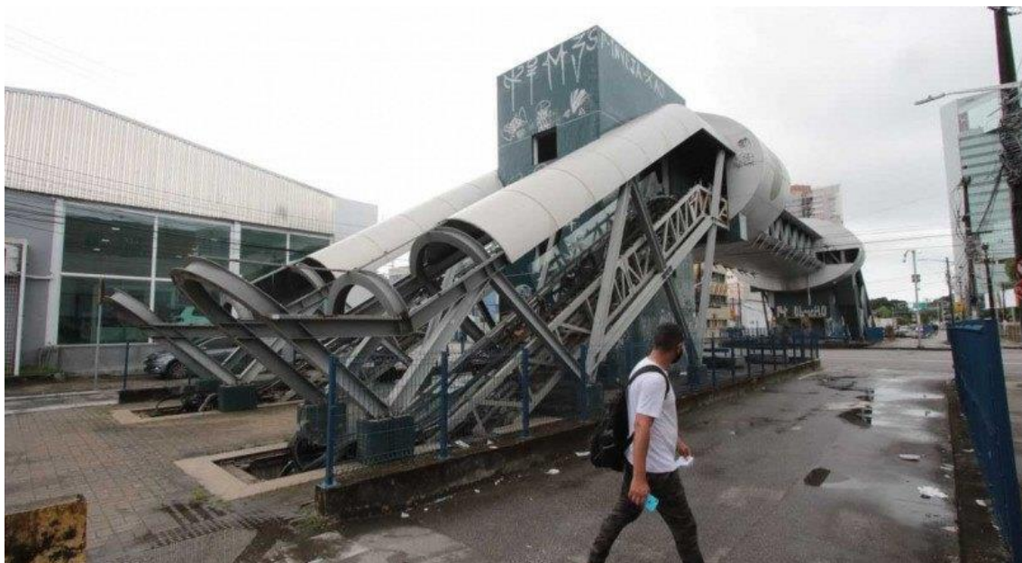
Passarela localizada na Avenida Herculano Bandeira, no Pina, não é mais utilizada pela população há 5 anos - FOTO: ALEXANDRE GONDIM/JC IMAGEM
